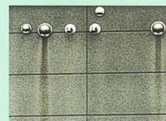
涙漏れによる外壁の変色
