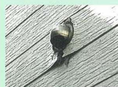
外壁 (サイディング) の凍壊
