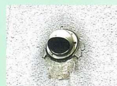
外壁 (モルタル) の凍壊
